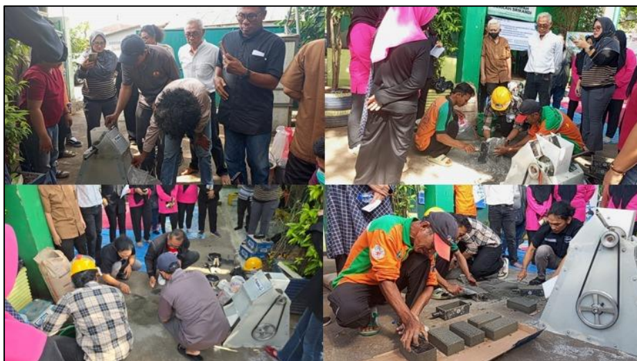
Gambar 6. Proses Pencacahan Plastik, Pencampuran Material, dan Pencetakan Paving Block Dengan Material Campuran Plastik
